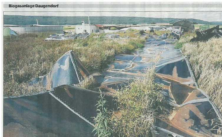
Vor über acht Monaten ist die Biogasanlage in Daugendorf havariert. Laut Gutachten waren Baufehler am Fermenter die Ursache dafür. Noch immer liegen Teile des geplatzen Fermenters an der Unglücksstelle. SZ-Foto: Thomas Warnack
